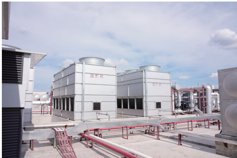
光纤激光产业园循环水冷却系统
