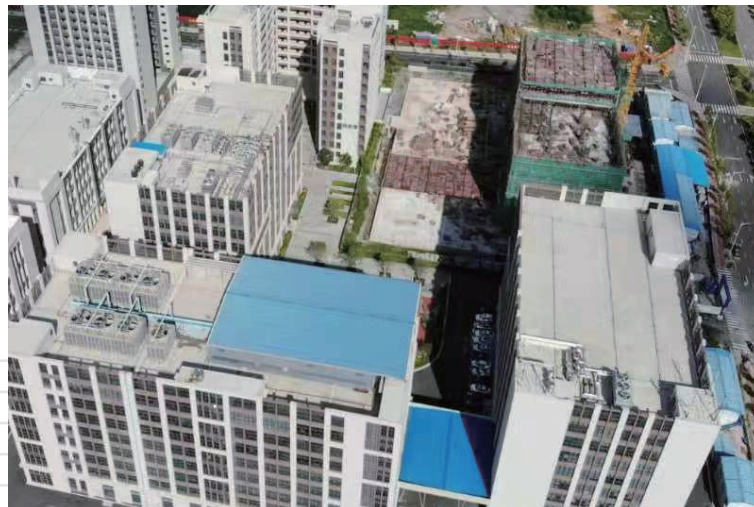
屋顶光伏装置
